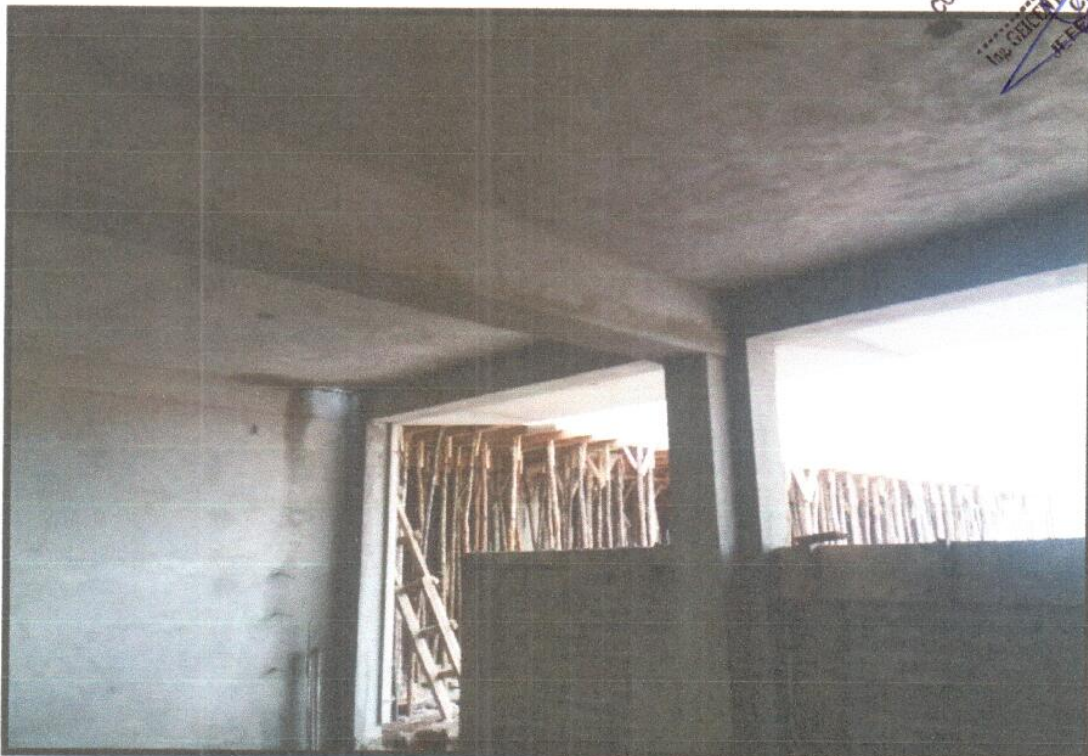
FOTO N°08: TARRAJEO EN MURO: INTERIOR CON MORTERO, VIGAS Y CIELO RASO CON MEZCLA. MODULO 03
